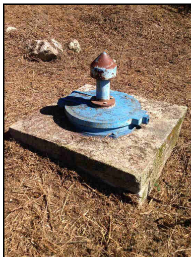
Captage Pitraghju 1, cuveau de collecte
