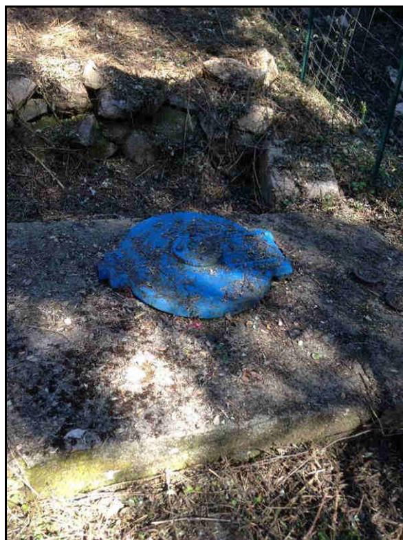
Source de Petraghju 2, cuveau de collecte
